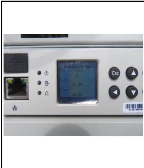
Existing Rectifier Load #1
